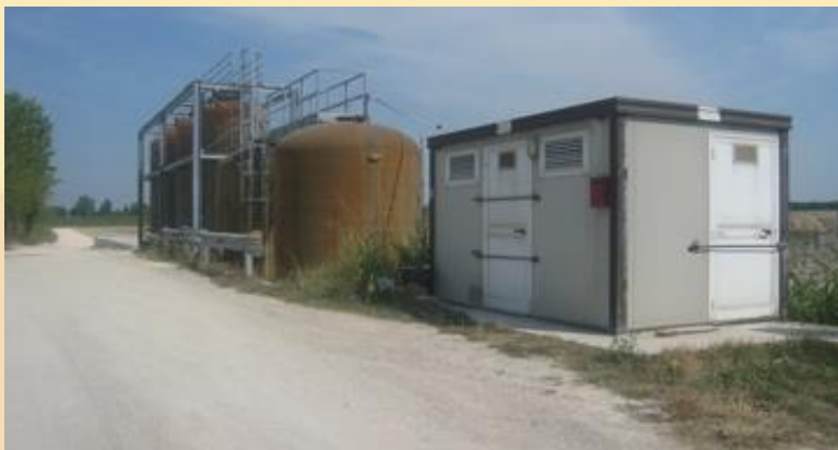
Serbatoi di accumulo del percolato
