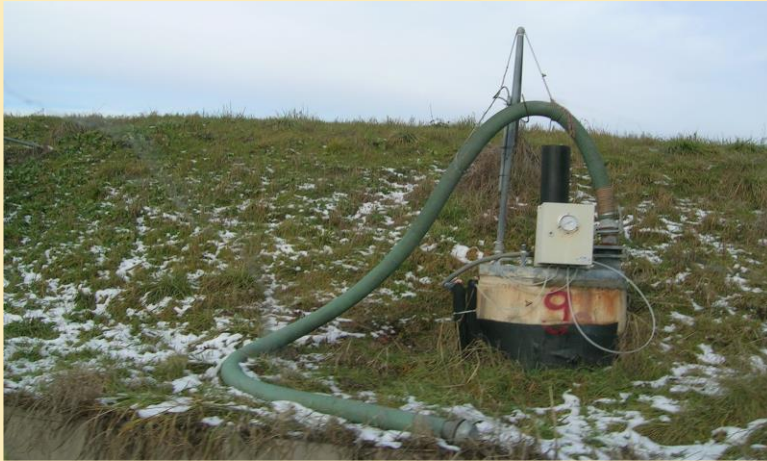
Pozzo di raccolta del percolato
